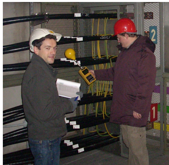
Slika 1: Mesto, kjer so bile izmerjene najvišje vrednosti gostote magnetnega pretoka v bližini SN zbiralk v RTP s 40 MVA transformatorjem in SN delom na 10 kV.
